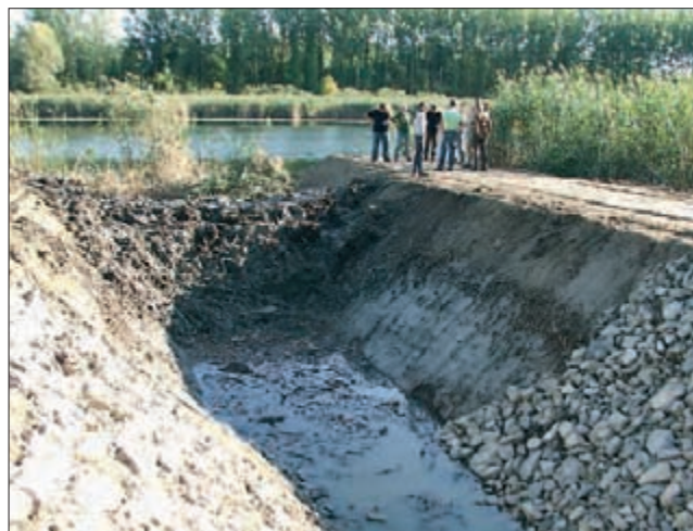
Канал Сирота, уз Бајски канал; октобар 2012; измуљивање канала Сирота који се протеже кроз већи део Лабудњаџе, у функцији управљања водним режимом (фото: С. Пузовић)
